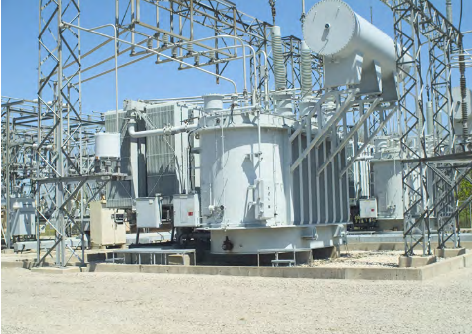
Banque triphasée de transformateurs utilisée pour la distribution d'énergie.
